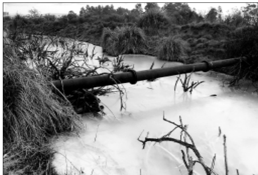
Tubería de vertidos de Solvay / Fotos: Archivo
